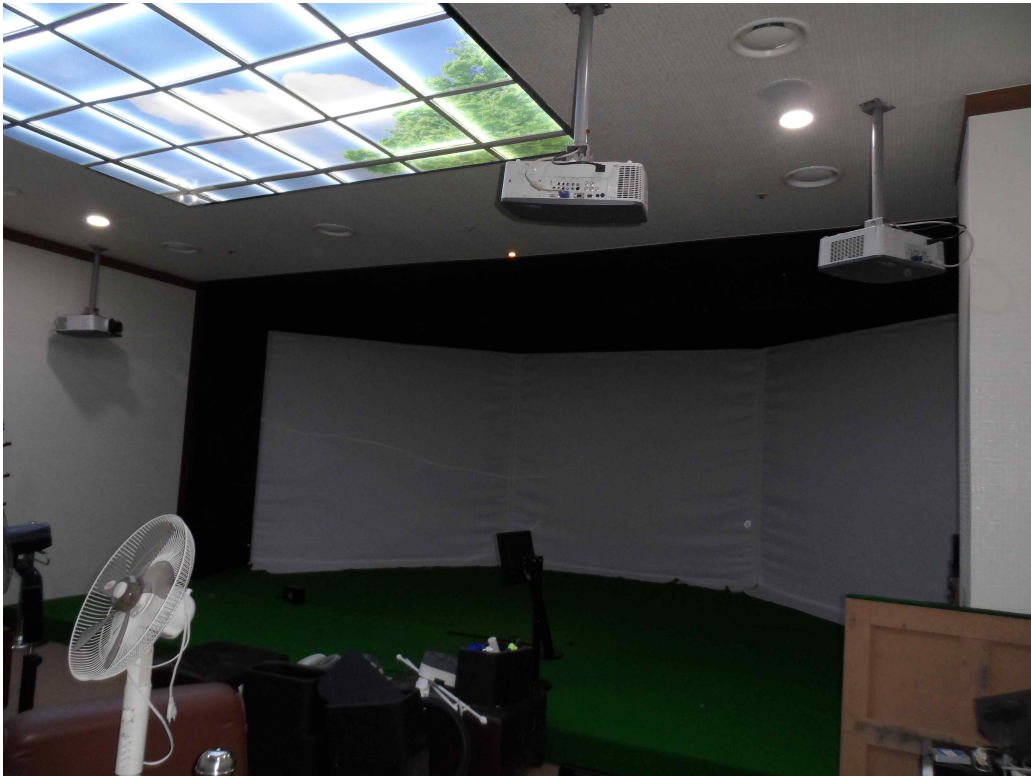
3. 스크린골프장비(골프나인팁) 1대 - 설치된 상태
