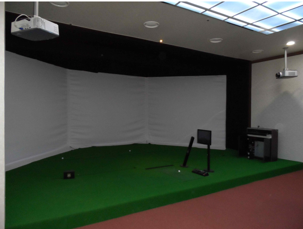
4. 스크린골프장비(골프나인팁) 1대 - 설치된 상태
